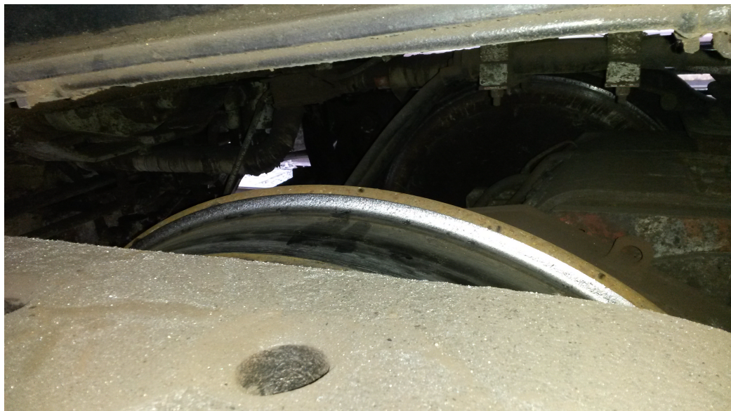
Le métal sur le bourrelet de l'essieu à un aspect rugueux et des copeaux d'acier sont visibles sur le châssis du bogie et sur la base des rails.
